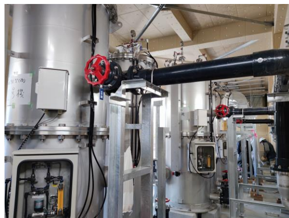
高濃度酸素水浄化施設 (高濃度酸素水による河川の硫化水素対策)
