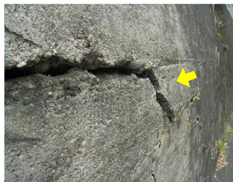
擁壁工のはらみ出し
