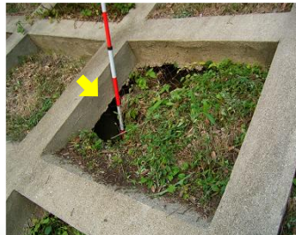
法枠工の陥没、裏抜け
