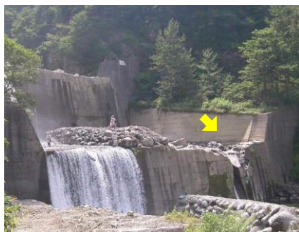
水通し天端の磨耗・損傷
