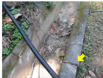
水路工の破損
