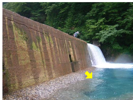
水叩き工の磨耗・損傷
