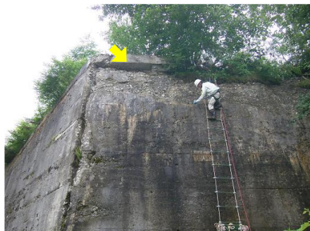
堤体表面の剥離（凍害）
