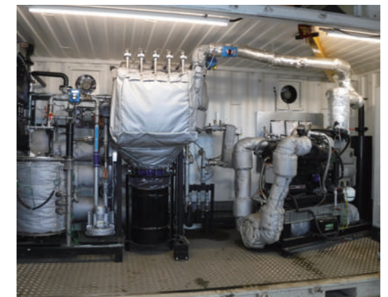
木質CHP（発電能力45kW）
