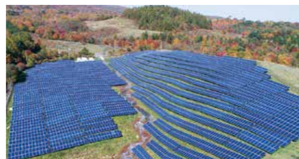
釜石檜ノ木平太陽光発電所
