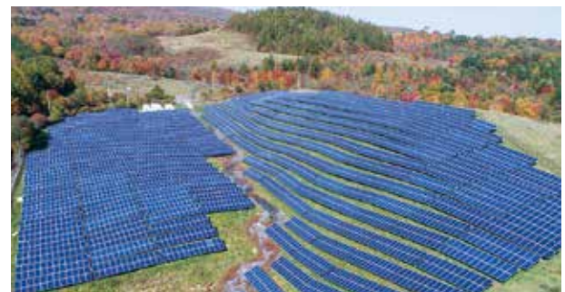
釜石檜ノ木平太陽光発電所
