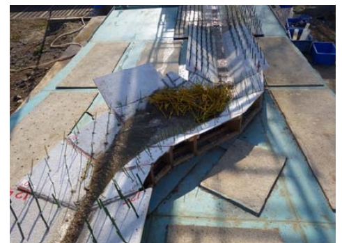
写真5 湾曲部のせり上がり状況
