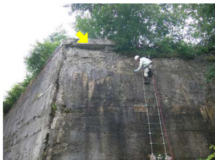
堤体表面の剥離(凍害)
