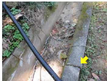
水路工の破損
