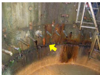
集水管の孔口付着物
