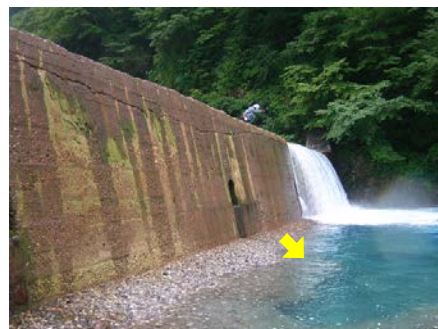
水叩き工の磨耗・損傷
