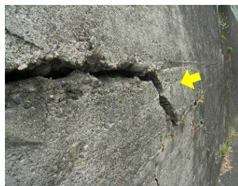
擁壁工のはらみ出し
