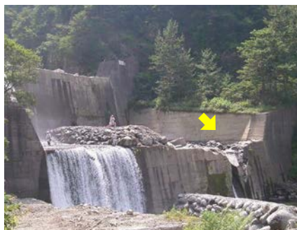
水通し天端の磨耗・損傷
