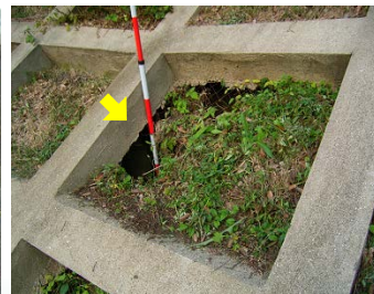
法枠工の陥没、裏抜け
