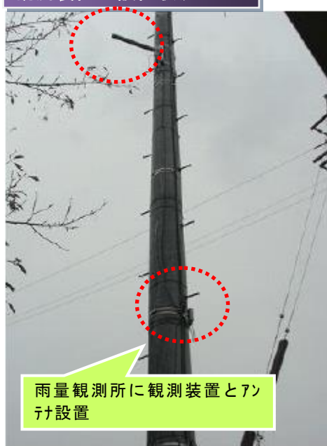
観測装置 設置状況
