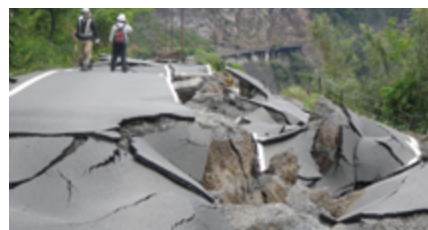
熊本地震直後の道路被災状況（2016年4月）
