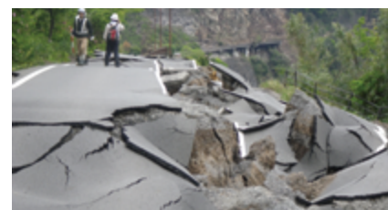
熊本地震直後の道路被災状況（2016年4月）
