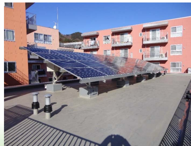
屋根を借用した発電施設(大町)
