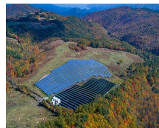
太陽光発電事業 (釜石橋ノ木平太陽発電設備)
