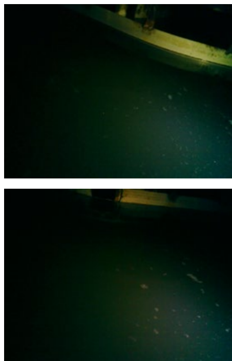
図4-2 暗視カメラで撮影した最終沈殿池の状況 (攪拌機の稼働状況)
