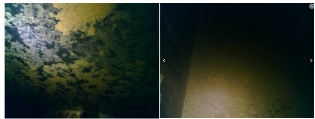
図3-12 異常時(左:最終沈殿池, 右:反応タンク)
