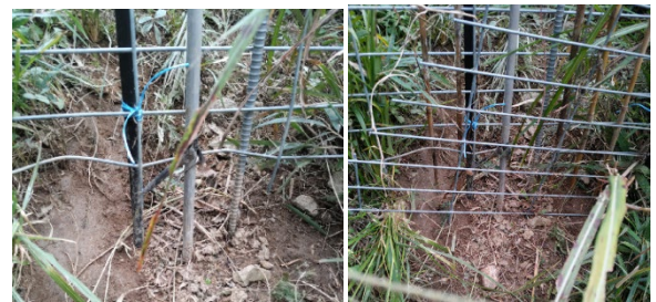
写真-6.4 侵入防護柵の修正前（左）と修正後（右）
