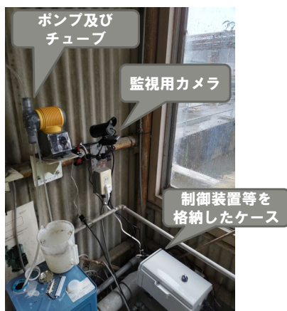
図 3-10 ポンプ制御システムの設置状況
