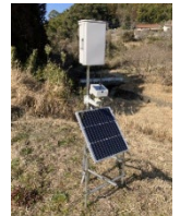
写真-6.4 遠隔監視カメラ
