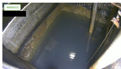
図3-2 機械油流出の事例
